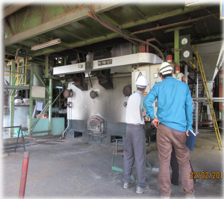
BOILER KAPASITI 8t
